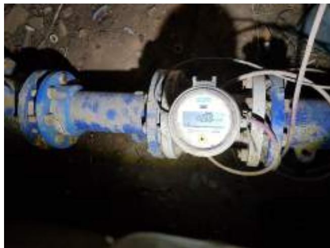
Débitmètre Siemens Mag8000 – PA-Q2
