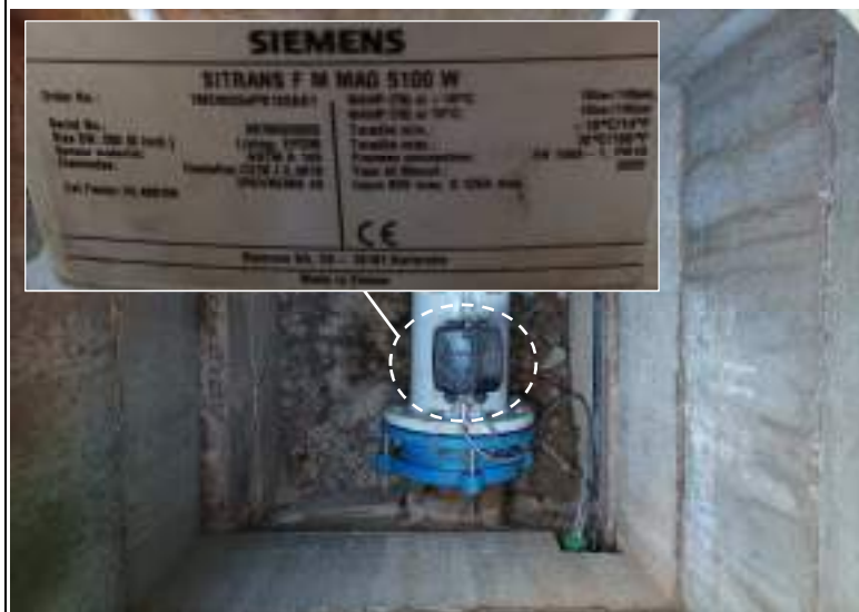
Débitmètre "Haut Service" dans regard extérieur
