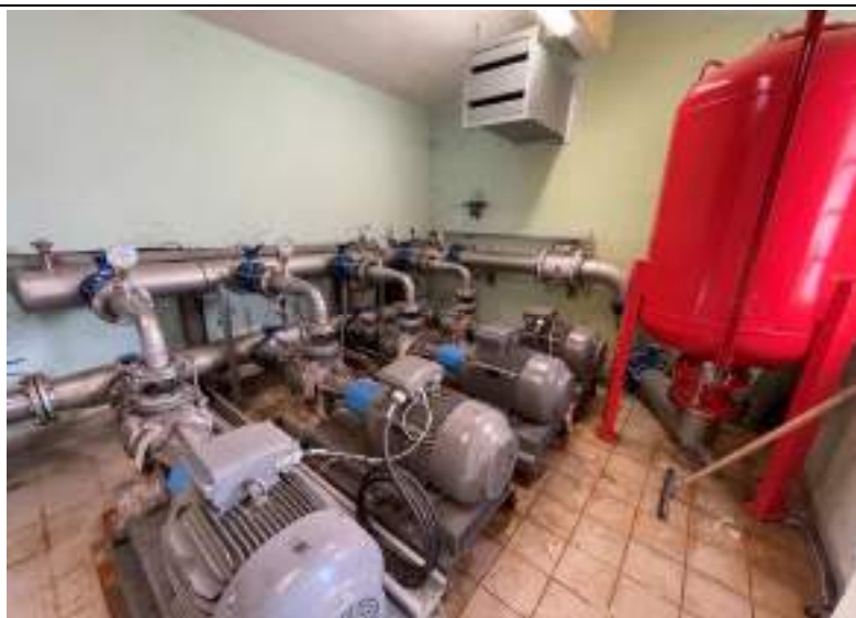
Chambre de vannes
