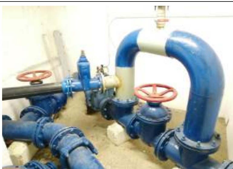
Chambre de vannes
