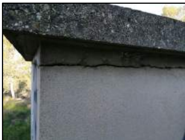
Figure 42 : Vue extérieure du réservoir de Saint-Etienne-du-Grès avec dégradation extérieure du bâtiment
