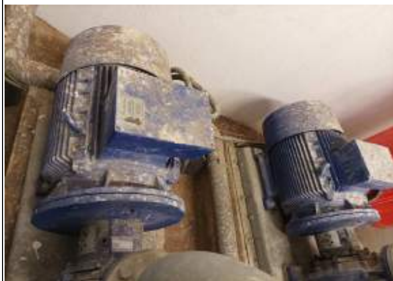
Reprise vers le réservoir des Alpilles
