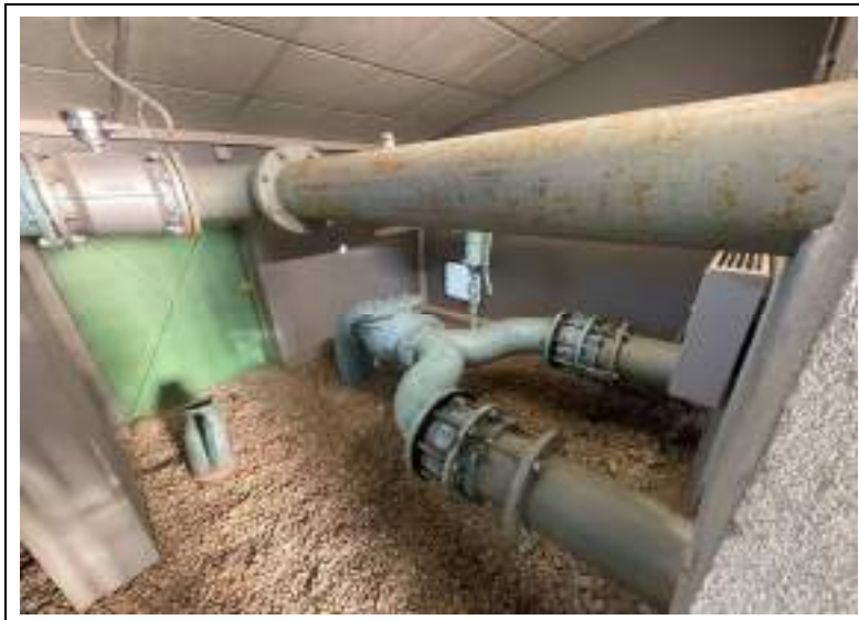
Conduite d'exhaure et conduite de distribution avec débitmètre
