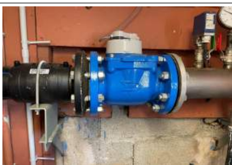
Conduite de distribution avec compteur
