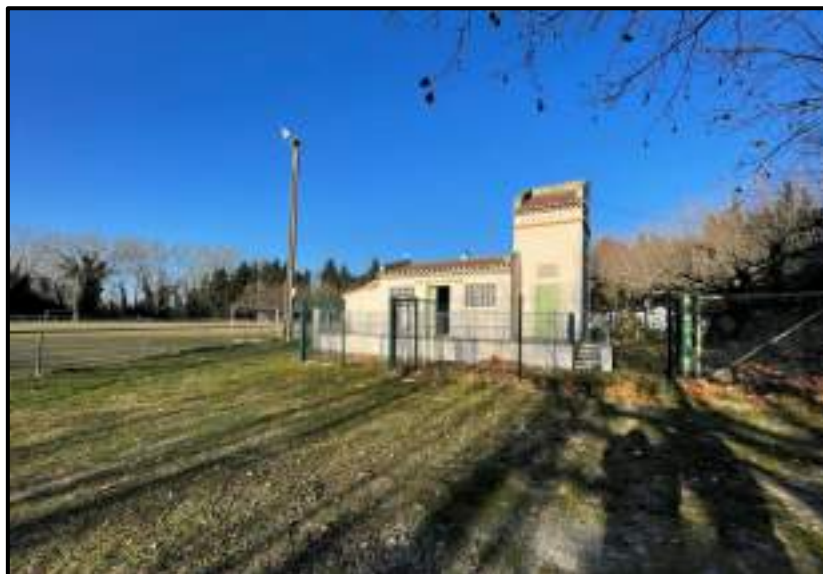
Figure 18 : Vue extérieure du forage La Malotière
