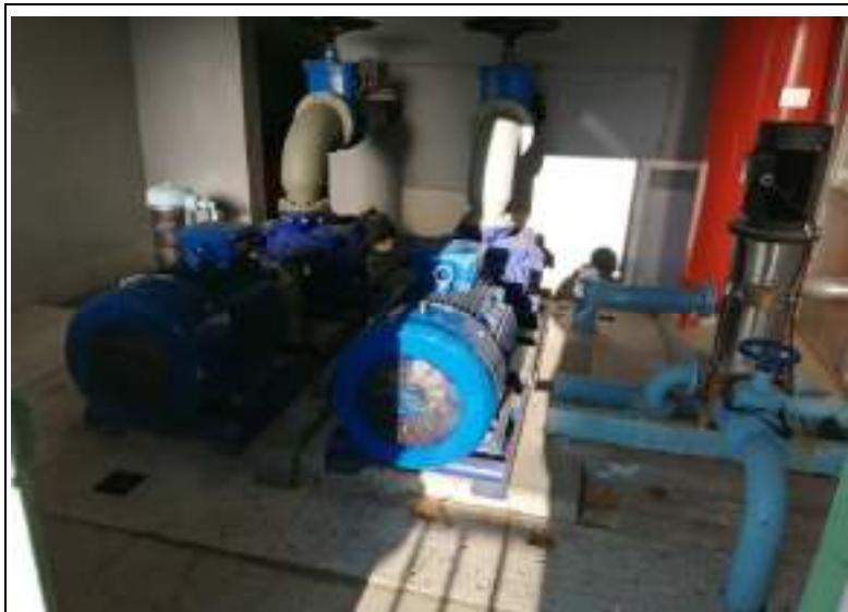
Groupe de pompage
