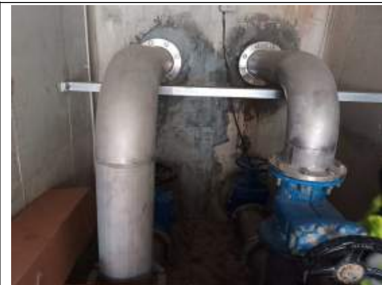
Chambre de vannes
