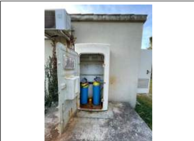
Local de chloration
