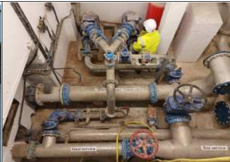
Chambre de vannes (N-1) - partie Ouest
