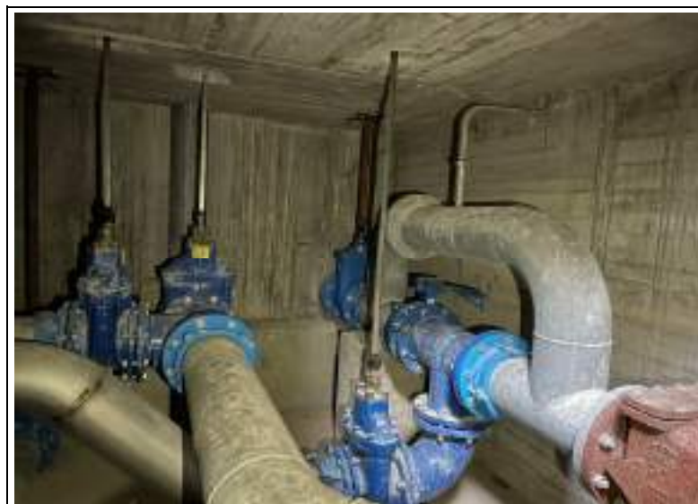
Chambre de vannes
