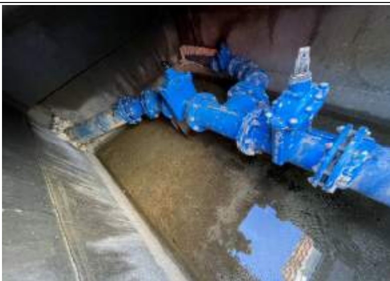
Regard distribution vers réservoir Eygalières et "Village"
