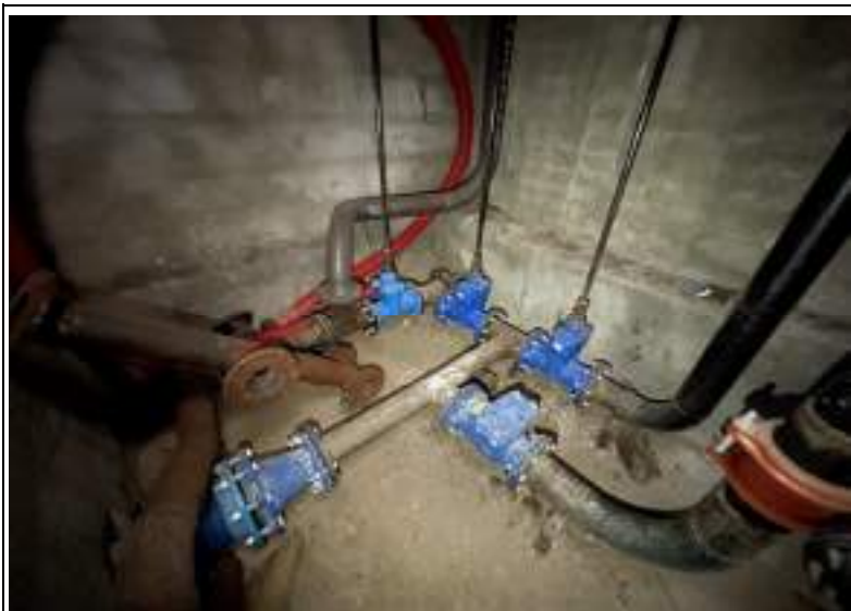
Chambre de vannes (Niveau -1)
