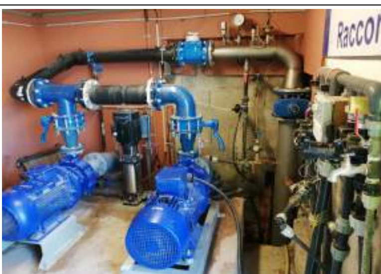
Groupe de pompage
