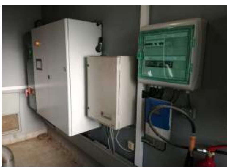
Armoires électriques et de commande
