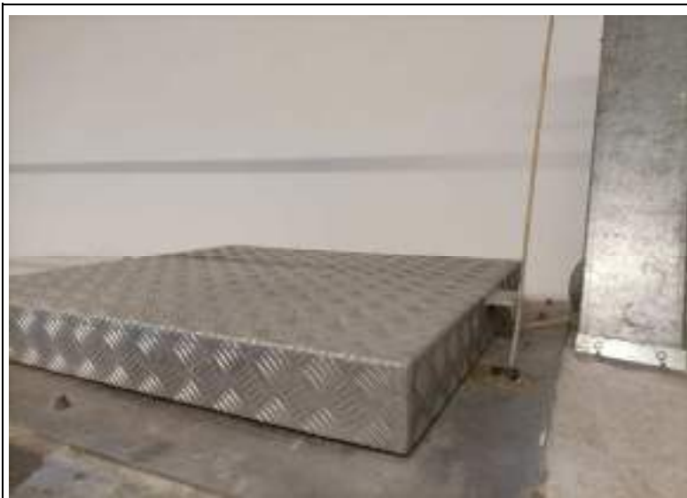
Trappe d'accès à la cuve Nord
