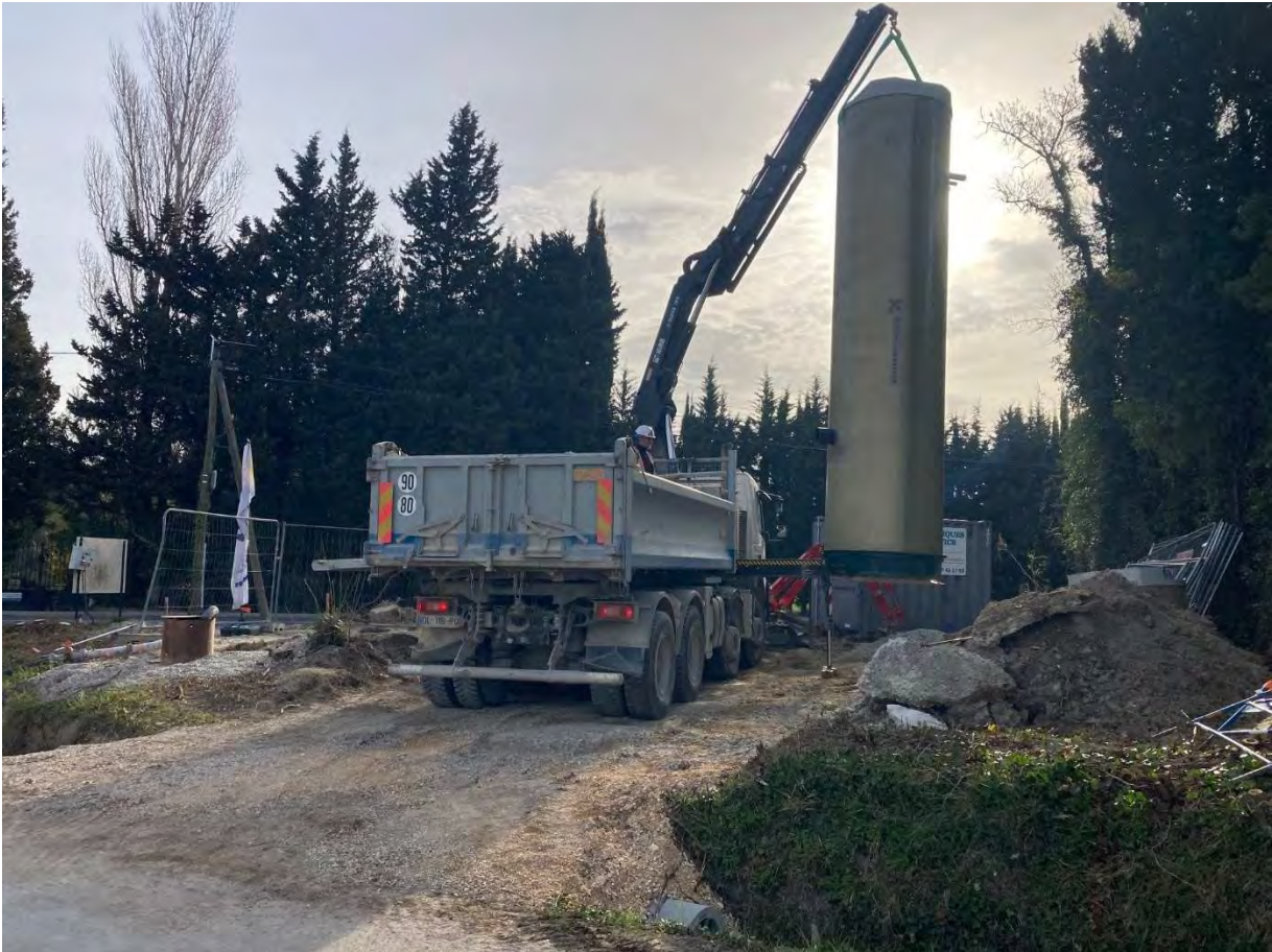
Poste de relevage Quartier des Jardins – Saint Rémy de Provence
